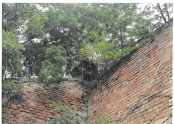
a Palota út felőli támfal részlete
