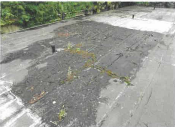
"K" épület tetőszerkezetének vízesedése
