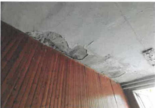
"K" épület - ázás a garázsban
