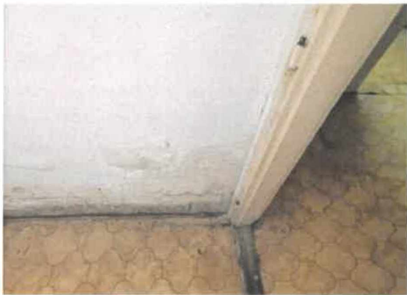
"K" épület - vizesedés a belső falon
