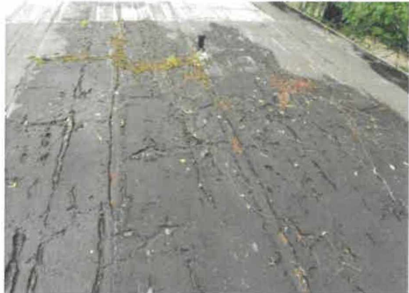
"K" épület tetőszerkezetének vízesedése
