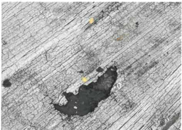
"K" épület tetőszerkezetének vízesedése, hiba a tetőszigetelésben
