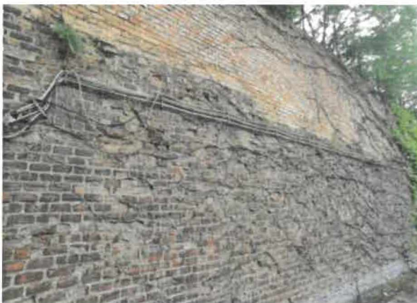
a Palota út felőli támfal részlete
